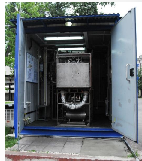
Расположение батареи ЭХГ в контейнере энергоустановки
